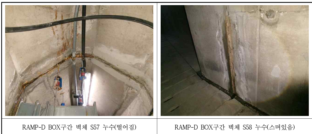
【사진 3.3.22】 BOX구간 벽체 손상현황
